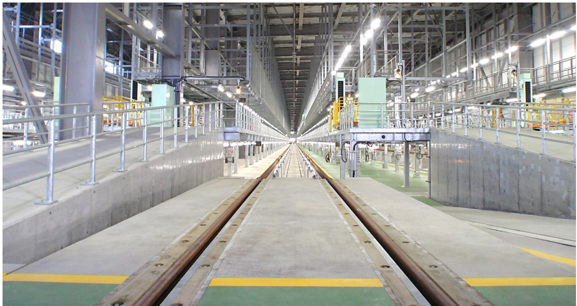
敦賀車両基地（電力設備）
