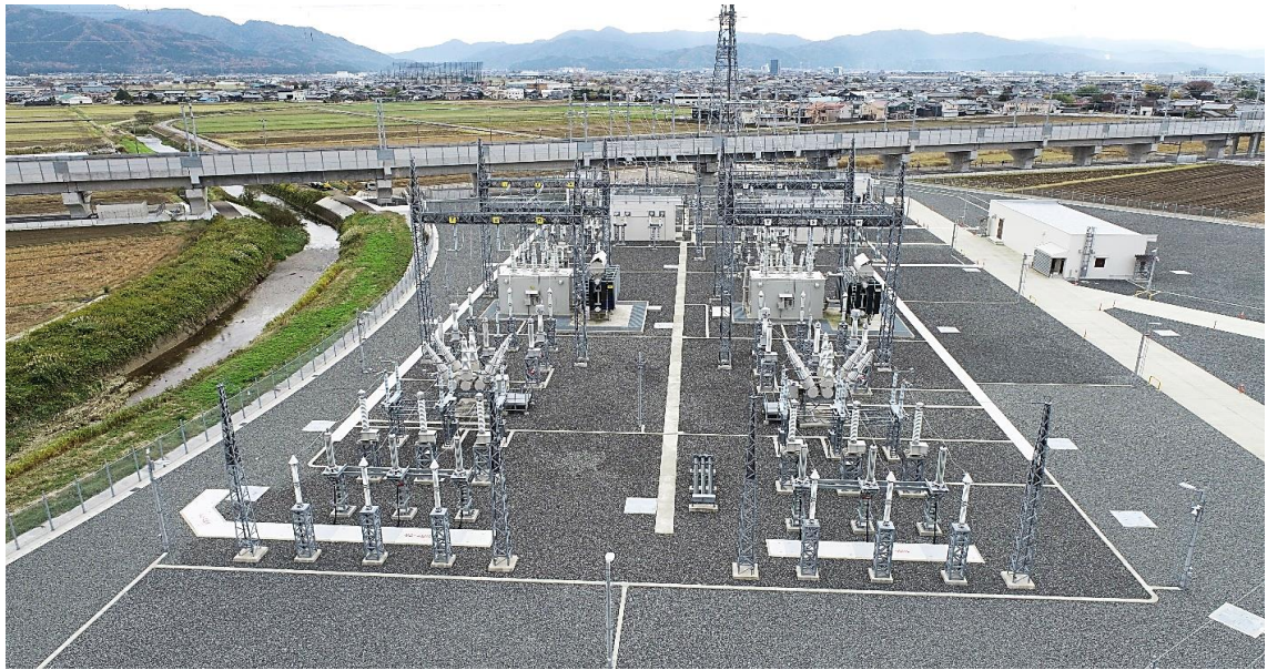
新坂井変電所（変電設備）
