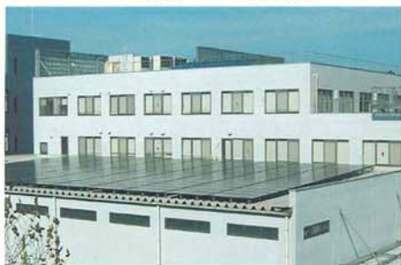
(株)新陽社多摩境テクノセンター(東京都町田市) 多結晶 50kW 高圧系統連系
