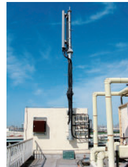
携帯電話基地局 (東京都江戸川区)
