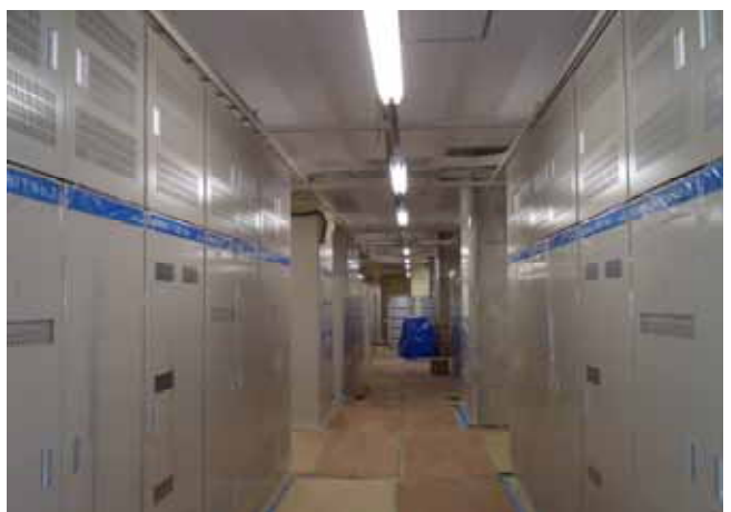
新糸魚川駅配電所 配電盤新設
