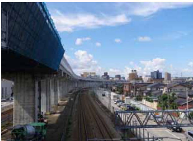
富山県富山市 富山稲荷千歳高架橋 (鉄道建設・運輸施設整備支援機構HPより)
