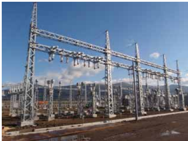
函館総合車両基地変電所
