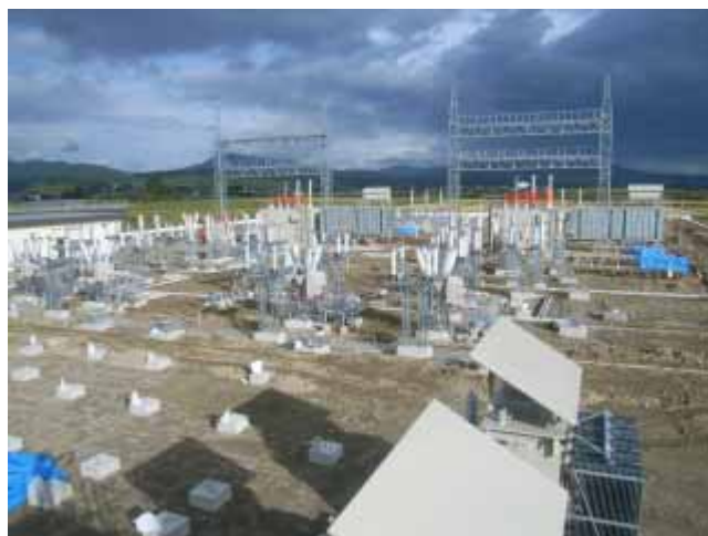
函館総合車両基地変電所
