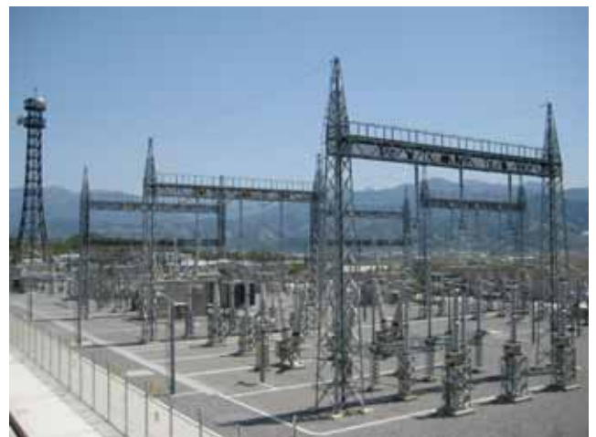
新長野変電所
