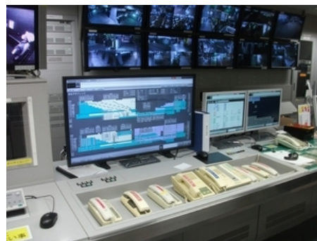
京都駅ビル 防災センター
