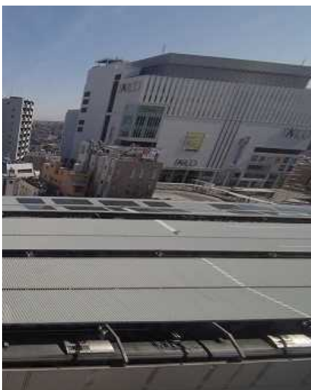
ホーム屋根上太陽光パネル
