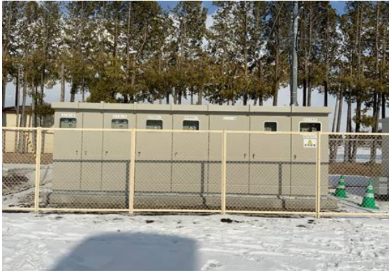
新設キュービクル
