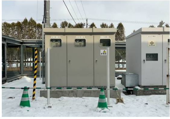
電源切替盤〈商用電源・太陽光/蓄電池〉 (鹿追町トリムセンター受電盤に併設)
