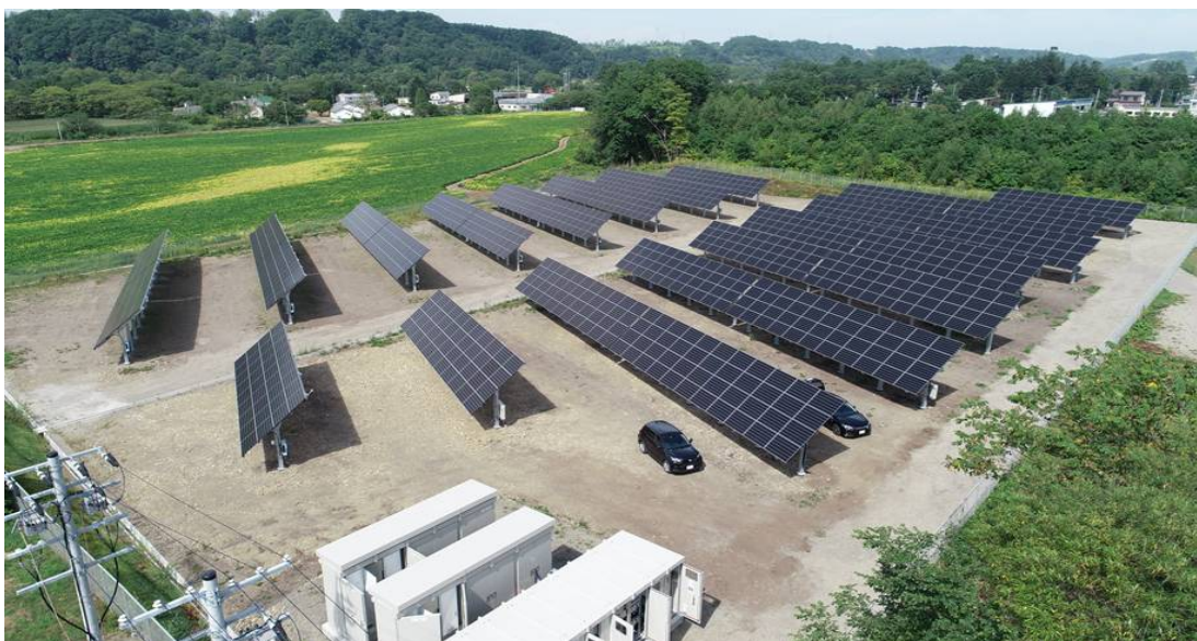
太陽光発電所
