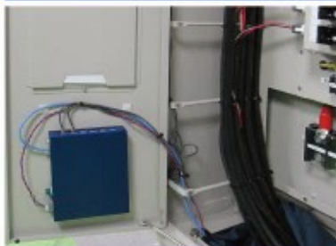
電源監視ユニットで遠隔監視が可能
